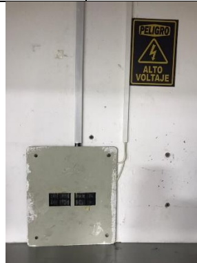
Señalética tablero eléctrico
